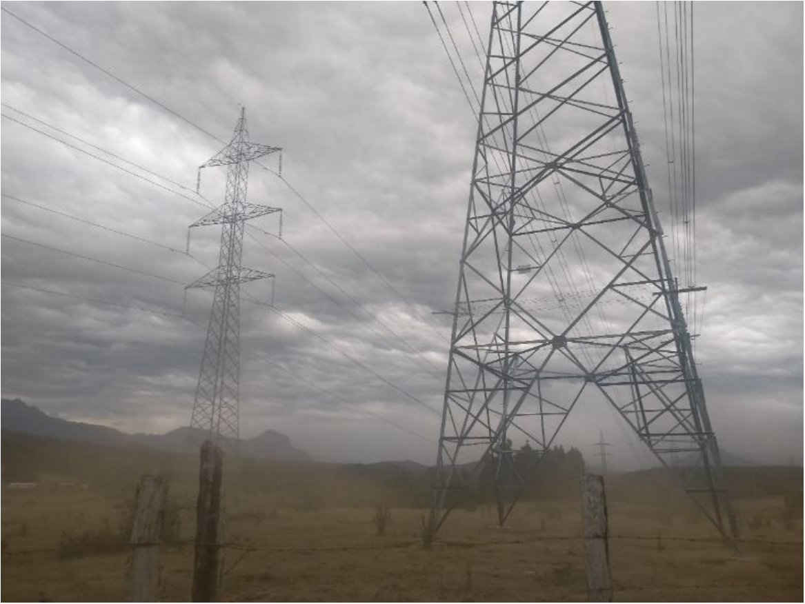
(Torres de alta tensión en los terrenos de la comunidad de Ayin Mapu)
