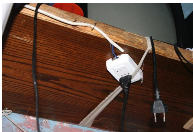
Figura 19. Conexiones eléctricas en celdas de patio 3
