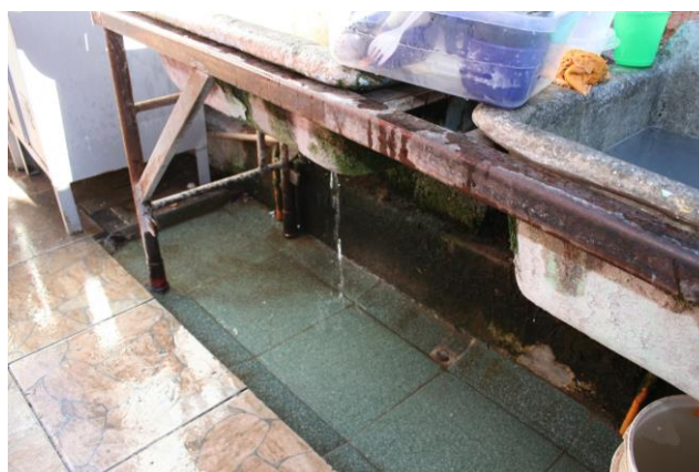
Figura 7. Filtraciones de agua en módulo de mujeres. Fuente: Instituto Nacional de Derechos Humanos
