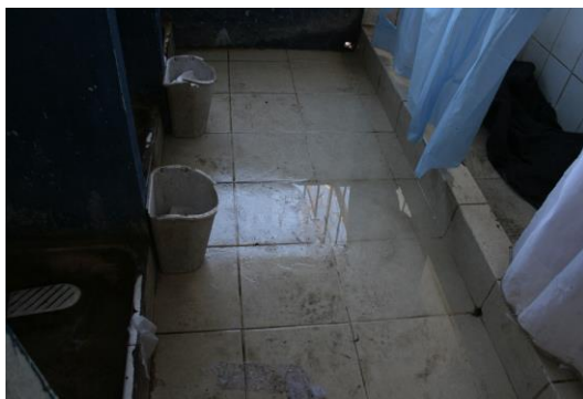
Figura 21. Filtraciones de agua patio 3
