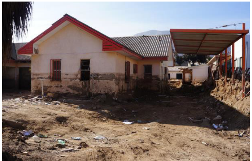
FIGURA 8 Imagen muestra daños que aún persisten en Chañaral. Fuente: INDH.
